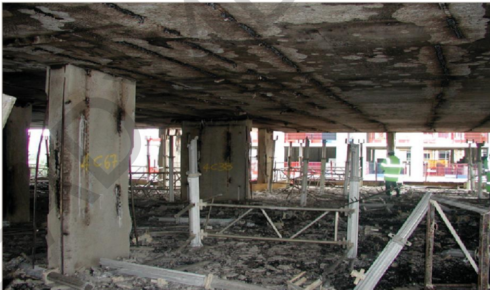
Εικόνα 4.10. Πυρκαγιά σε κτίριο οπλισμένου σκυροδέματος
